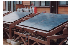
山小屋に設置された太陽光発電パネル
